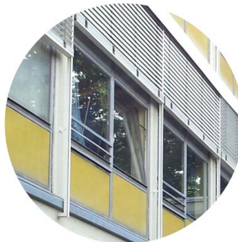
Variante Lamellenbehang (aktueller nachgerüsteter Zustand)
